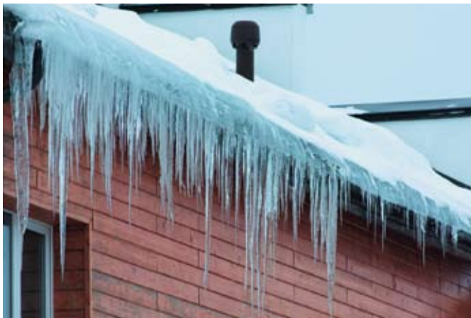
Рис. 1. Образование льда на поверхности кровли
